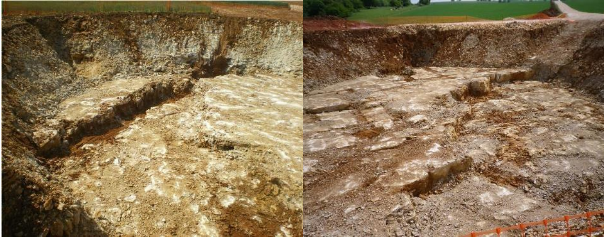
Photographie 1 : Exemples d'anomalies détectées après l'excavation qui ont nécessité une consolidation du fond de fouille avant la réalisation de la fondation superficielle
